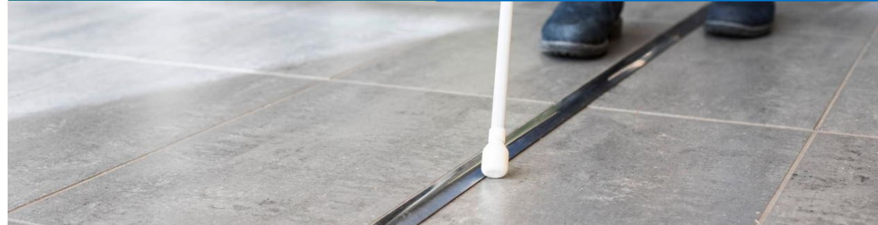
Kuva 26. Kulkemista ohjaava ohjuri sisälattiassa.
