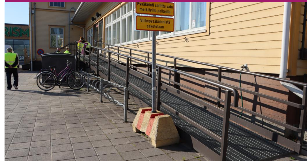
Kuva 23. Liian kalteva inva-ramppi.
