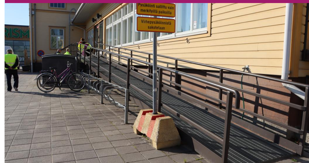
Kuva 23. Liian kalteva inva-ramppi.
