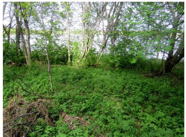
Kuva 8. Umpeen kasvanut varastonrakennuksen perustus Maa-Fantissa.
